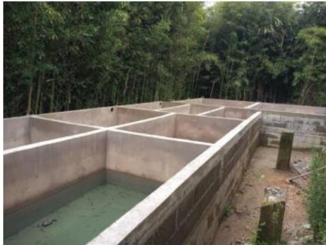
Figura 9. Tanques de sedimentación.
