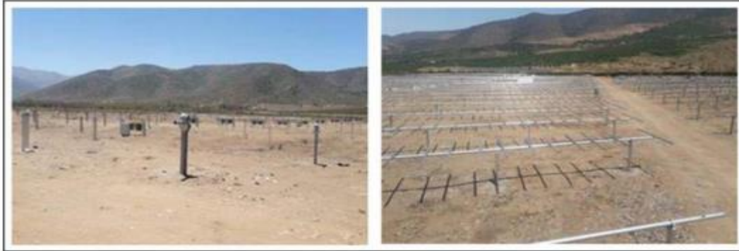
Imagen 8 Pilares de anclaje (izquierda) y estructuras de soporte (derecha) de los módulos
